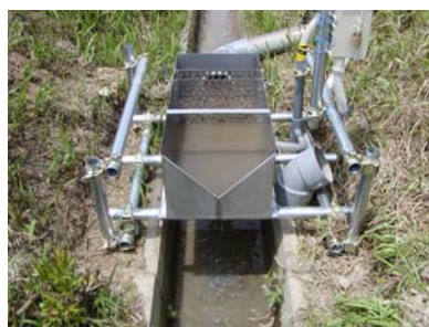
排水量測定三角堰
