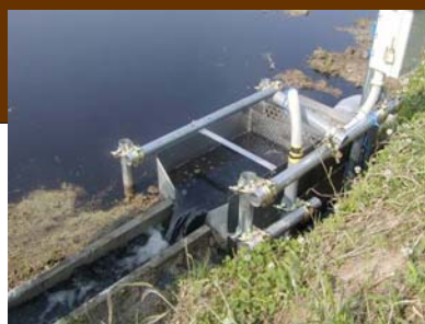
用水量測定三角堰
